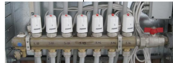
rozdělovač stropního chlazení
